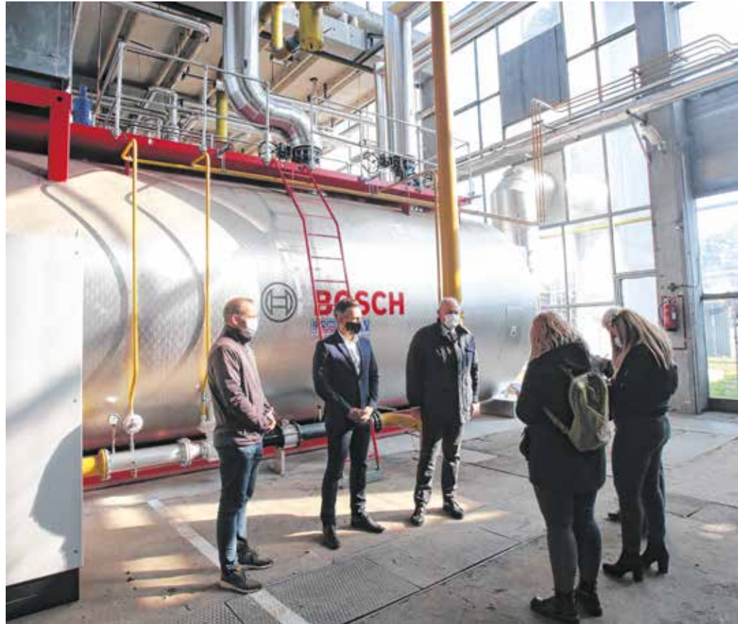
A Sopron Holding Zrt. új kazánja – a szobányi méretű szerkezet 17 megawatt teljesítményű, kétszer erősebb, mint a korábbi volt FOTÓ: FILEP ISTVÁN
